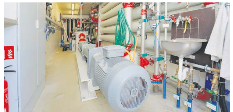
Im Technikraum beider Biogasanlagen befinden sich jeweils Substratpumpe, Verteilungssystem, Wärmetauscher und Steuerungstechnik.
