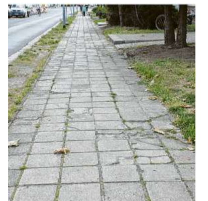
Stück für Stück sollen schlechte Gehwege in Herzberg erneuert werden. Foto: Rudow
